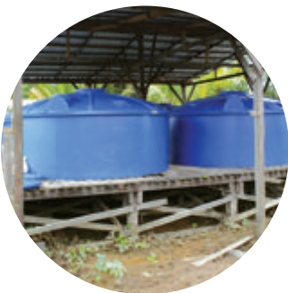
New water tanks and platform at Rumah Panjang Juung, Pulau Bruit
